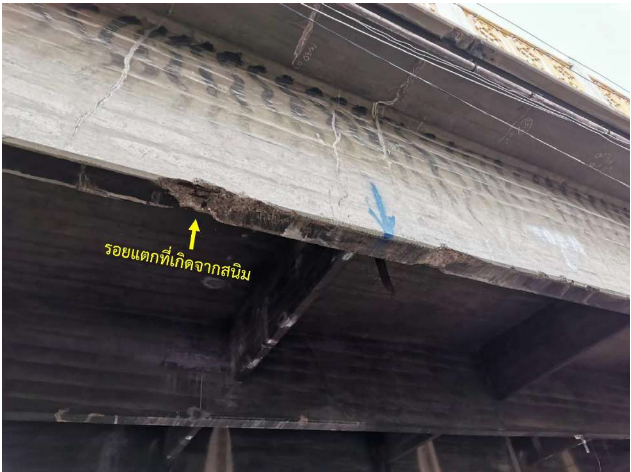
รูปที่ 16-12 สนิมที่เกิดขึ้นที่เหล็กเสริมและทำให้คอนกรีตกะเทาะ
