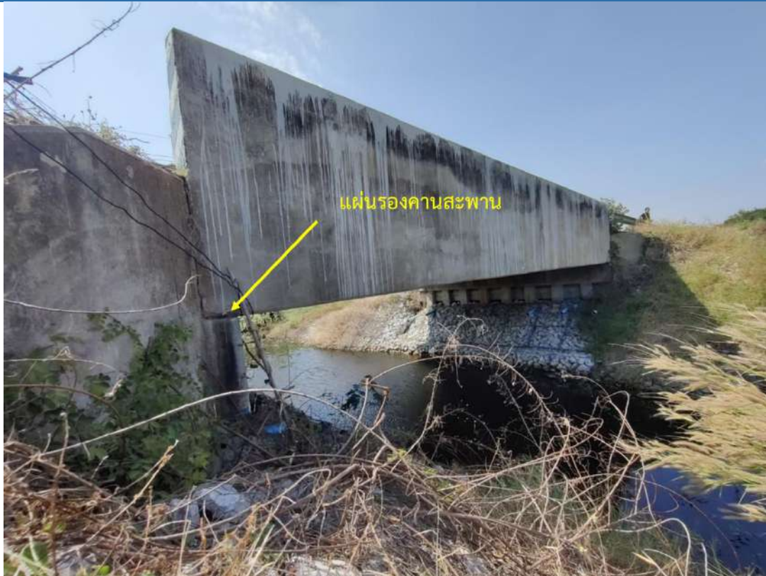
รูปที่ 16-8 แผ่นรองคานสะพาน
