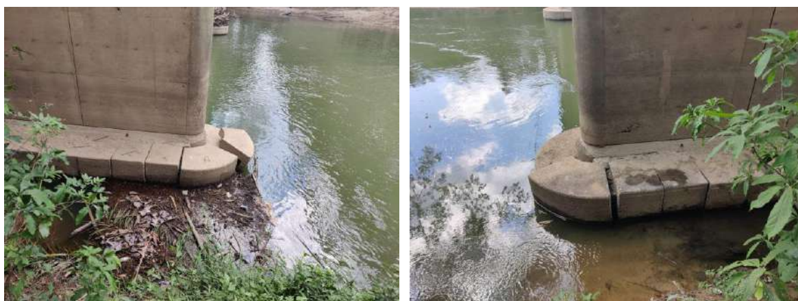
รูปที่ 11-3 ตัวอย่างภาพความเสียหายของสะพาน
